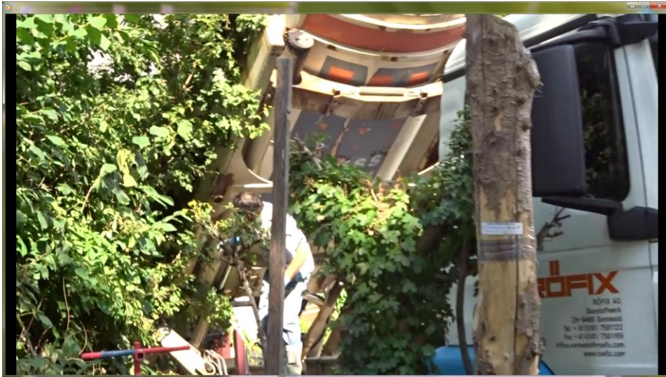
Pflanzen werden eingeklemmt und abgedrückt beim Aufladen des Betonsilos
